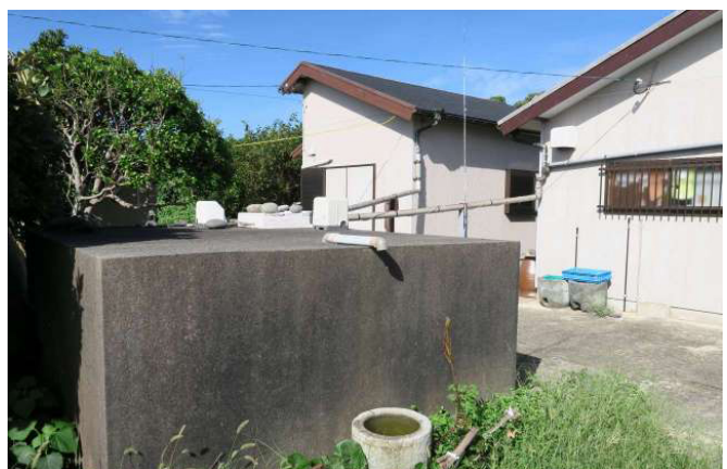
写真 8 赤島島内の戸建住宅と大型雨水貯留槽(約 6 m 3 )
