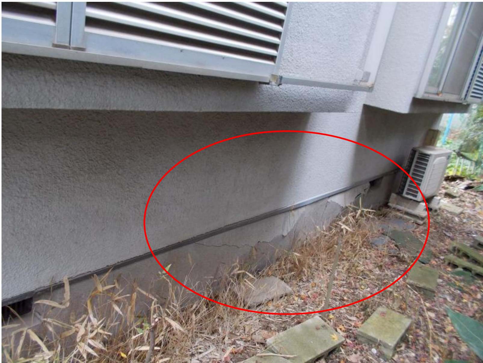
基礎部分の激しい亀裂(直上エリア):あまり例がない
