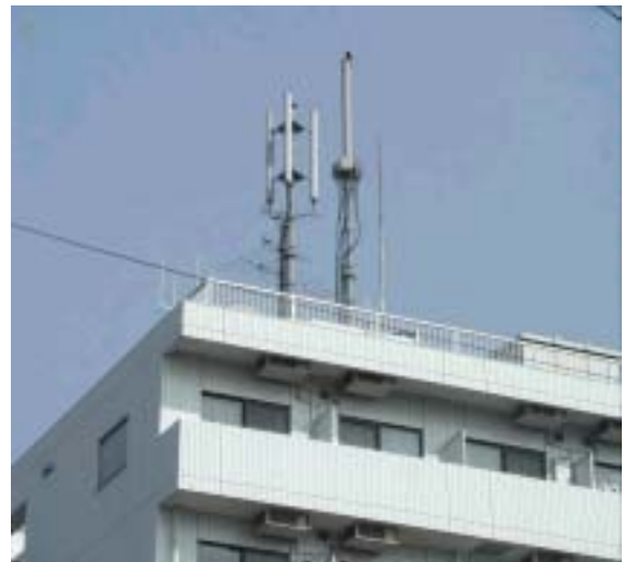
国立市のマンション屋上に立つ携帯タワーの一つ
