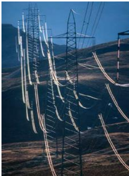
グリソンス州ラークス付近の 220 キロボルト高架送電線
