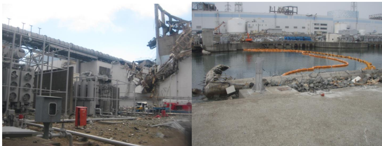
写真1) 福島第一原発構内2号機変圧器エリア
