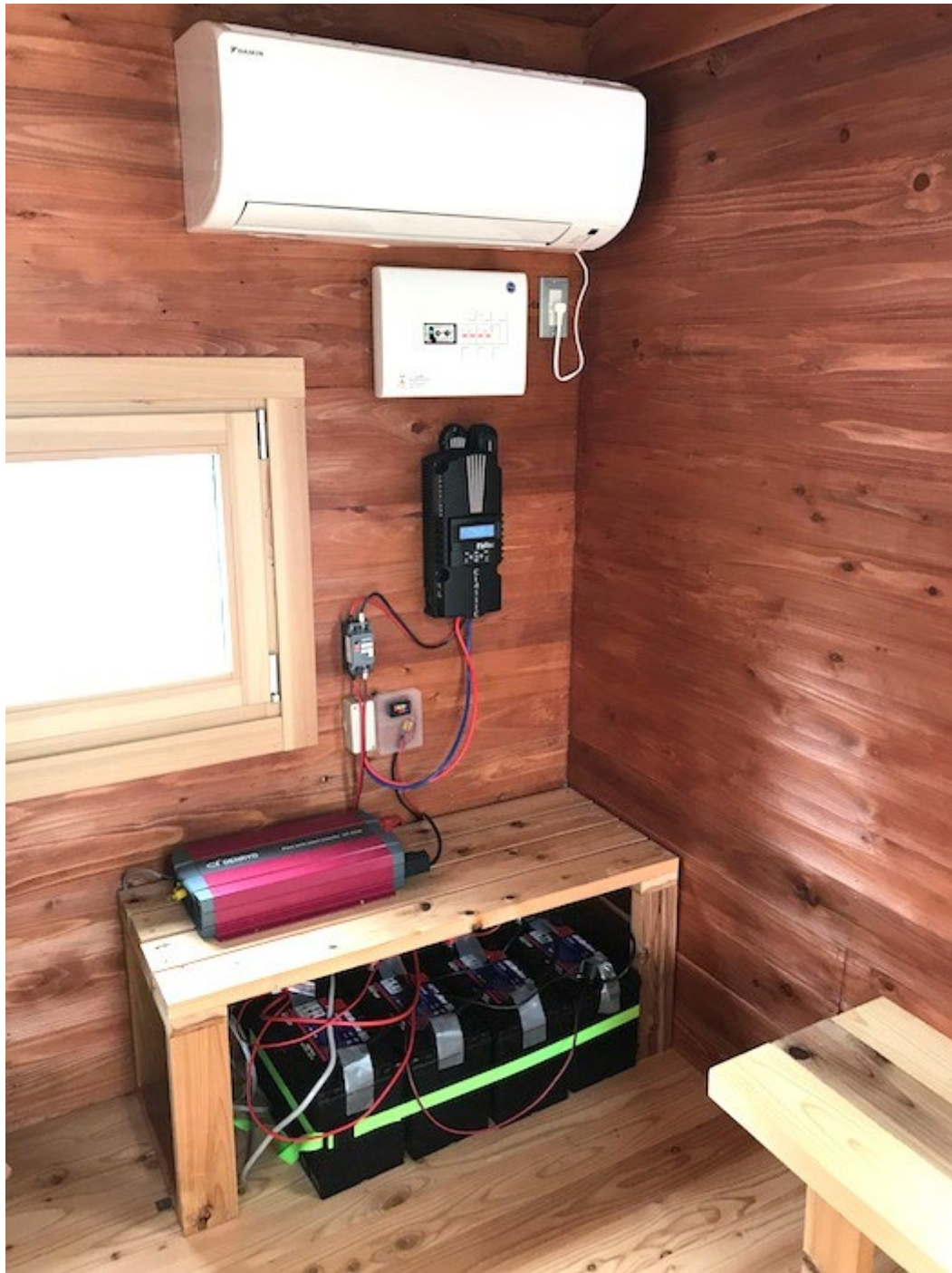
(充電コントローラー／インバーターとバッテリー廻り：蓄電モニターを設置)
