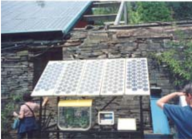
写真4：ソーラーポンプ
