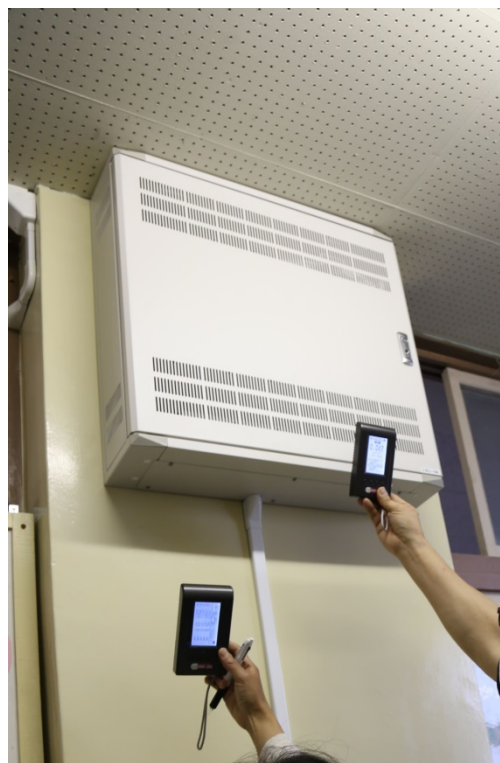
【写真 iii】教室の外側の、廊下に向けた側の壁に天井にあてて設置してあるフロアスイッチ
