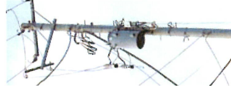
電柱の変圧器（ボルトトランス）つくば市市電
